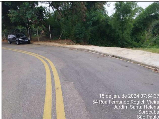
Foto 01 – pavimento com reparos (inicial)
