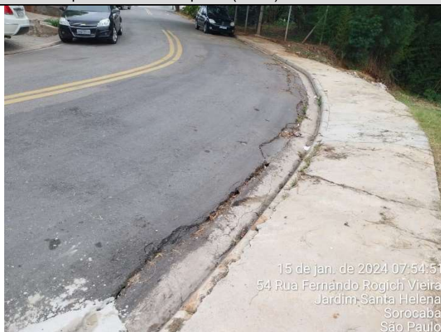
Foto 03 – pavimento com reparos (inicial)
