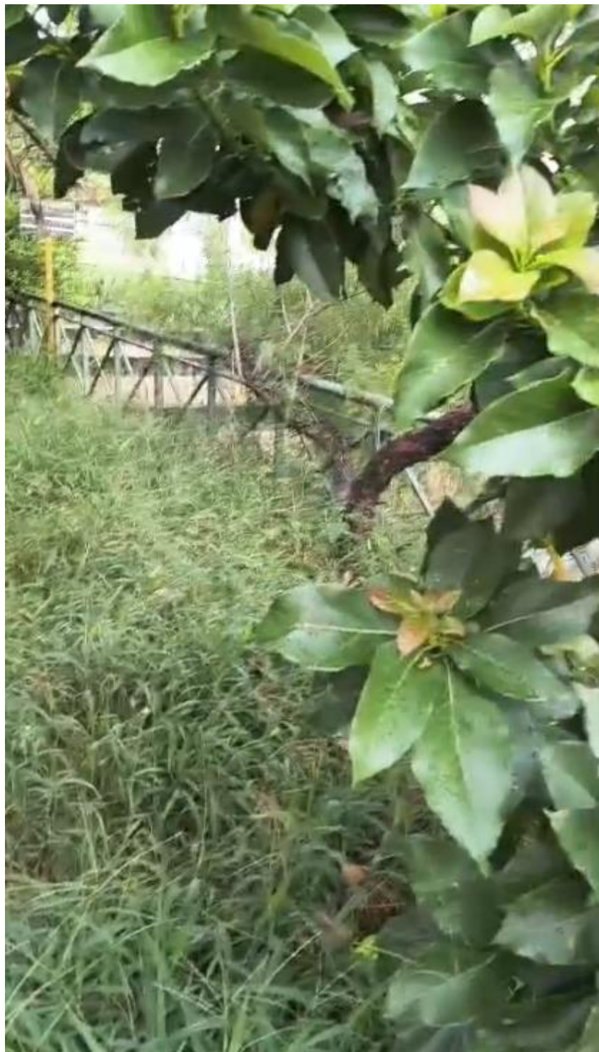
Gradil coberto pelo mato.
