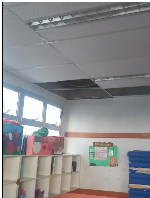
As placas do forro se desfazem com o vazamento
