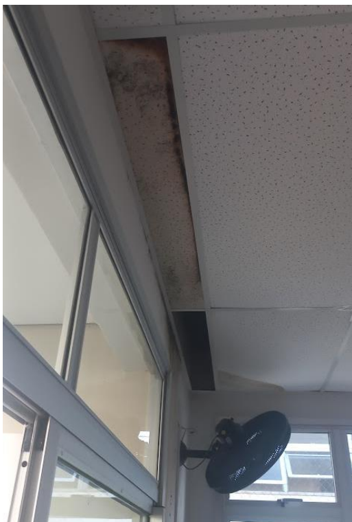
Infiltração no teto e paredes
