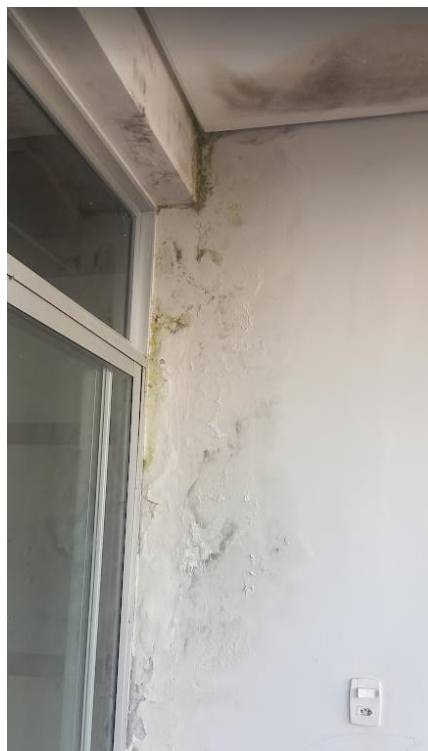
Infiltração no teto e paredes
