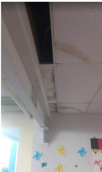
Infiltração no teto e paredes
