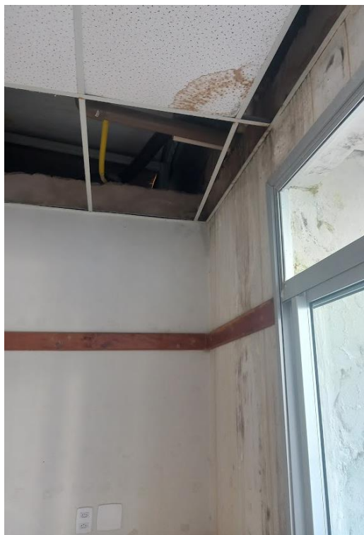
Aparentemente, existe um subdimensionamento das calhas.
