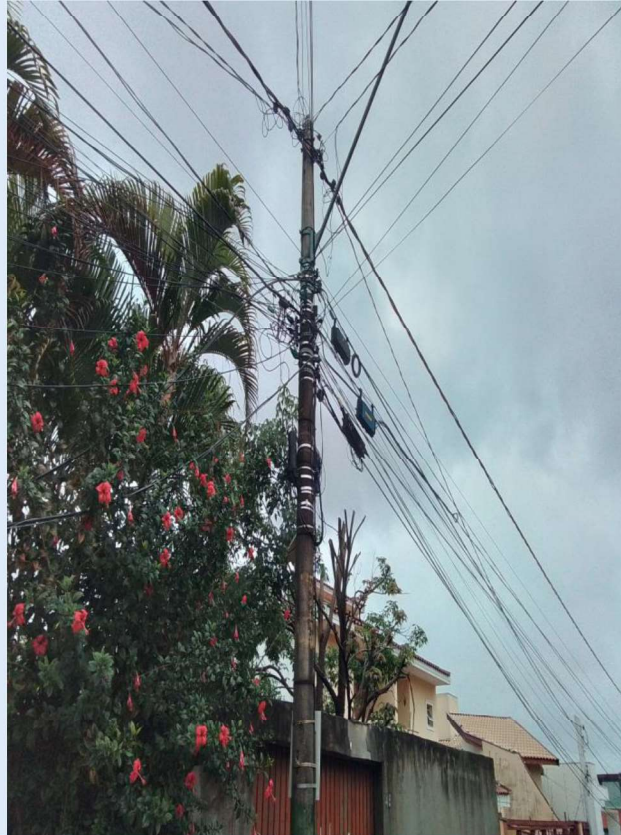
CABOS ROMPIDOS, CABOS BAIXOS, ESPINAR CABOS
