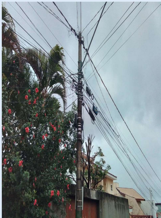
CABOS ROMPIDOS, CABOS BAIXOS, ESPINAR CABOS
