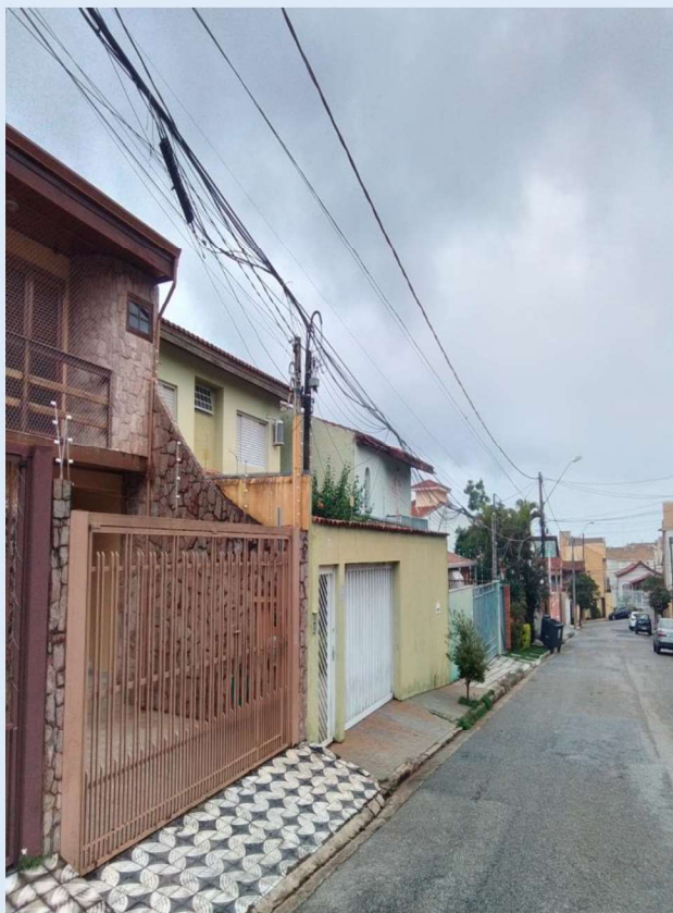
CABOS ROMPIDOS, CABOS BAIXOS, ESPINAR CABOS
