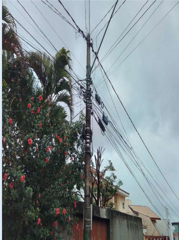
CABOS ROMPIDOS, CABOS BAIXOS, ESPINAR CABOS
