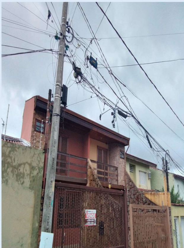
CABOS ROMPIDOS, CABOS BAIXOS, ESPINAR CABOS
