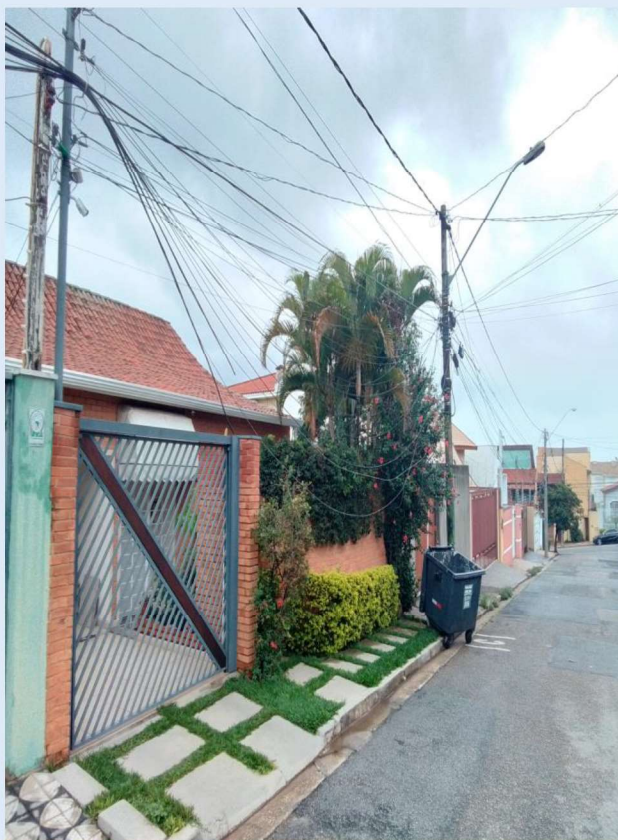
CABOS ROMPIDOS, CABOS BAIXOS, ESPINAR CABOS
