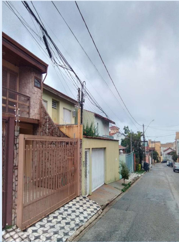
CABOS ROMPIDOS, CABOS BAIXOS, ESPINAR CABOS
