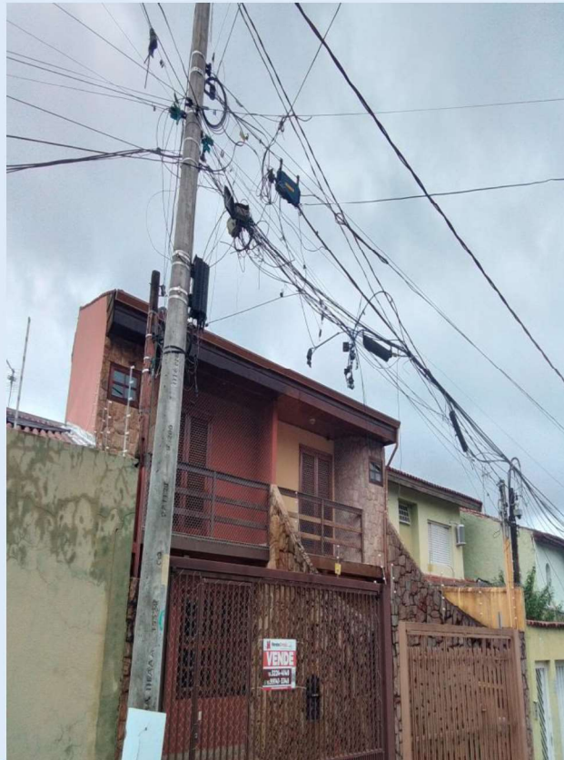
CABOS ROMPIDOS, CABOS BAIXOS, ESPINAR CABOS
