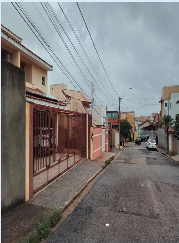
CABOS ROMPIDOS, CABOS BAIXOS, ESPINAR CABOS
