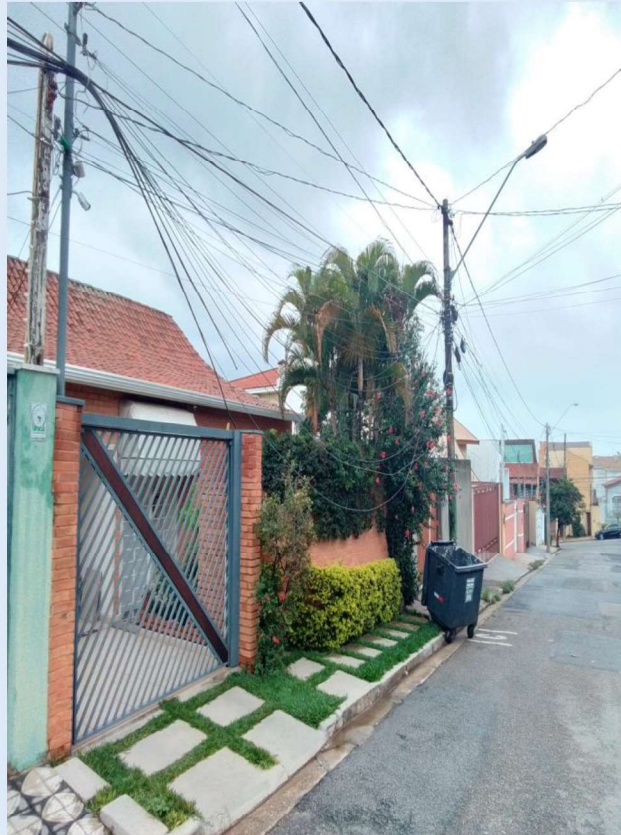
CABOS ROMPIDOS, CABOS BAIXOS, ESPINAR CABOS
