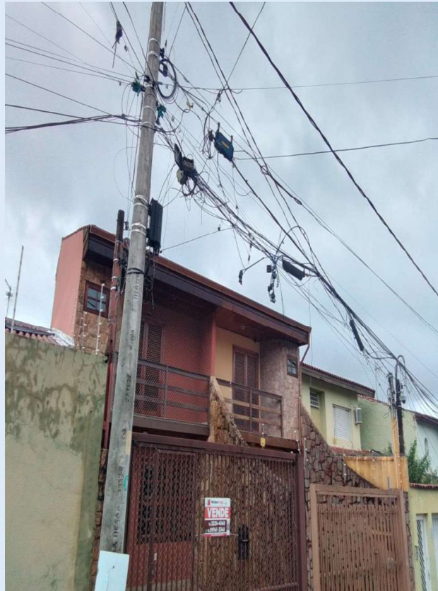
CABOS ROMPIDOS, CABOS BAIXOS, ESPINAR CABOS
