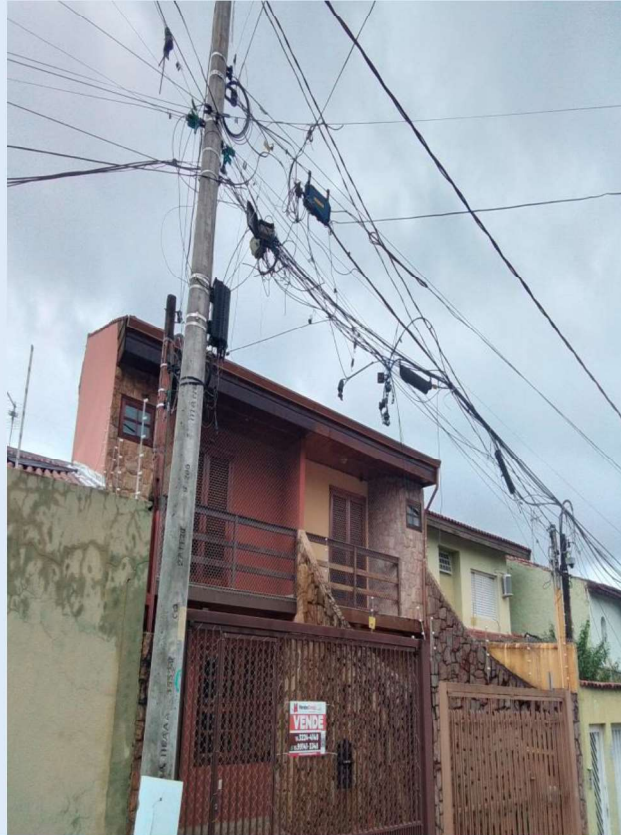
CABOS ROMPIDOS, CABOS BAIXOS, ESPINAR CABOS
