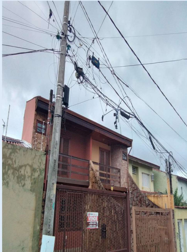
CABOS ROMPIDOS, CABOS BAIXOS, ESPINAR CABOS
