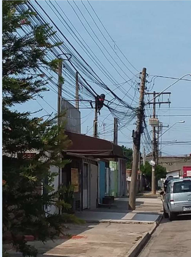
CABOS BAIXOS, AGRUPAR, ELIMINAR CABOS MORTOS.
