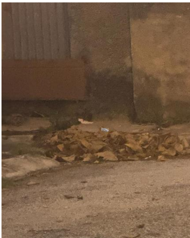
acúmulo das folhas obstruindo as bocas-de-lobo
