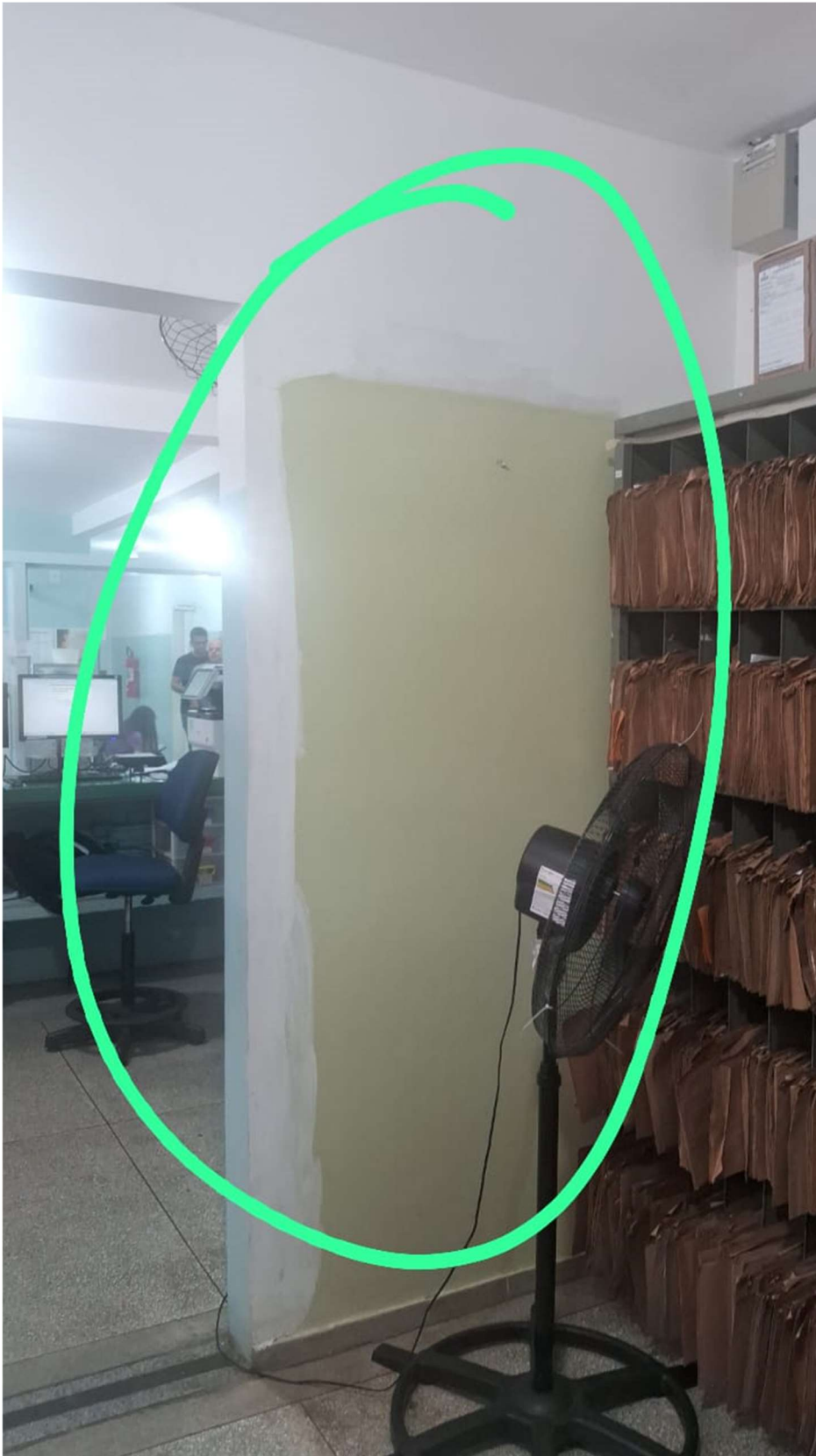
Falta pintura – em aberto da última reforma
