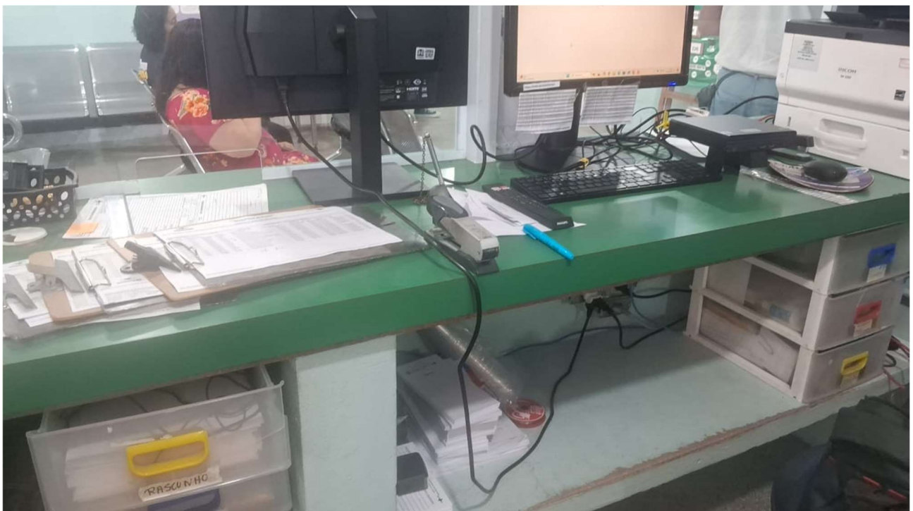
FIAÇÃO EXPOSTA DA RECEPÇÃO
